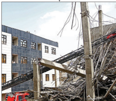
ریزش ساختمان در حال ساخت - مشهد
